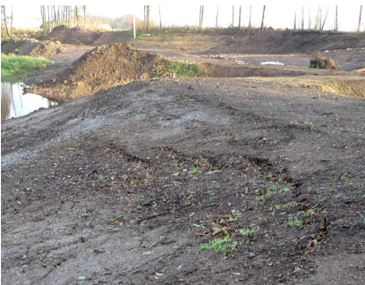
Vallar som innehåller mycket mull- eller torvjord kan lätt spricka med stora sättningar som följd.
