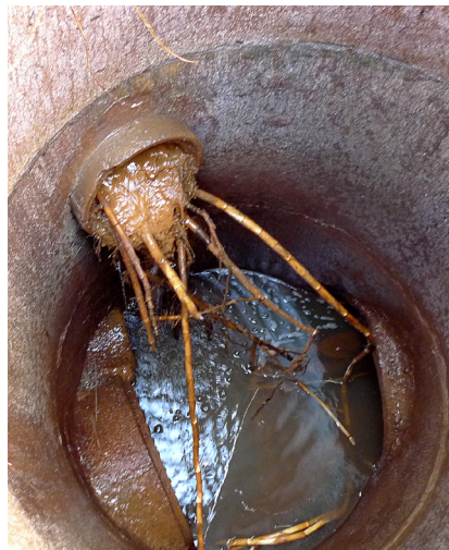
Vassens rötter har följt dräneringsröret ut i brunnen. Att kontrollera brunnar och ledningar är ett återkommande moment man inte får slarva med.
