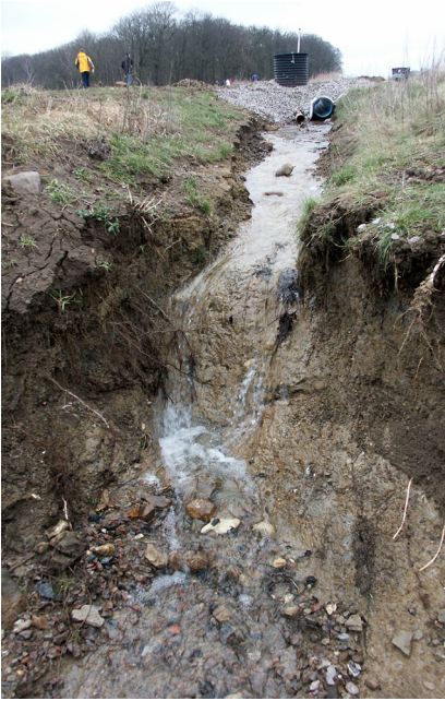
Fria utlopp är svåra att få stabila. Vattnet har en stor eroderande kraft.
